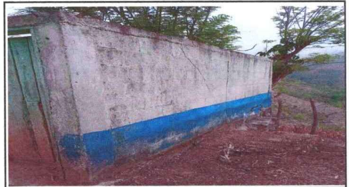
Foto 4: La infraestructura de la cocina en peores condiciones.
